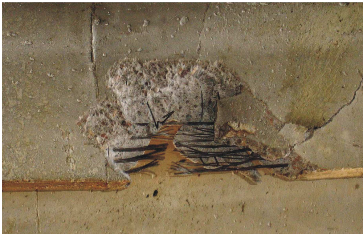
Rys. 3. Przerwane struny sprężające płyty dachowej PDS-1
