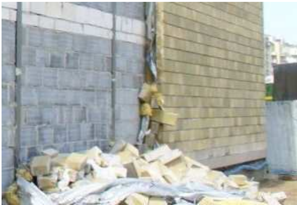
Rys. 1. Zawalony fragment elewacji
