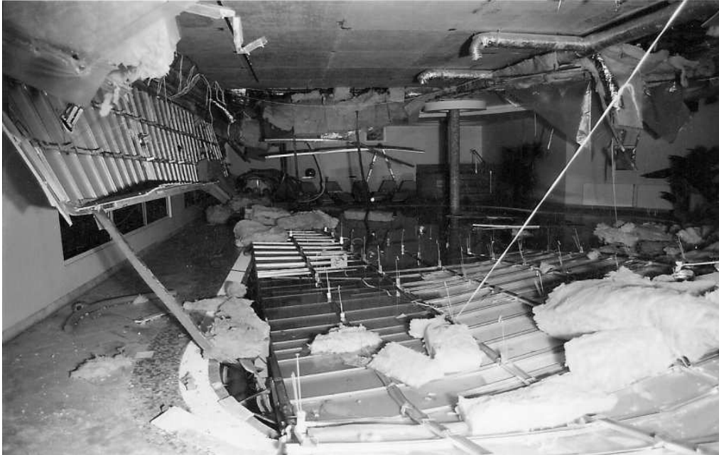
Rys. 2. Widok obrazujący zniszczenia stropu podwieszony po katastrofie budowlanej. Zniszczeniu uległ strop podwieszony nad całą powierzchnią basenu. Na suficie stropu żelbetowego nad basenem nie zachował się żaden kołek rozporowy. Wszystkie kołki zostały przy „wieszakach”
