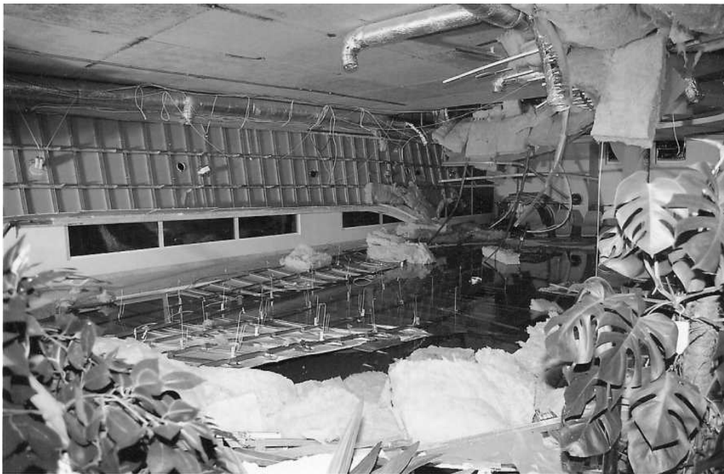
Rys. 1. Widok po katastrofie w pomieszczeniu rekreacyjnym. Oberwany strop podwieszony, częściowo zatopiony w wodzie. Widoczne są kołki rozporowe na wieszakach z drutu stalowego, ocynkowanego
