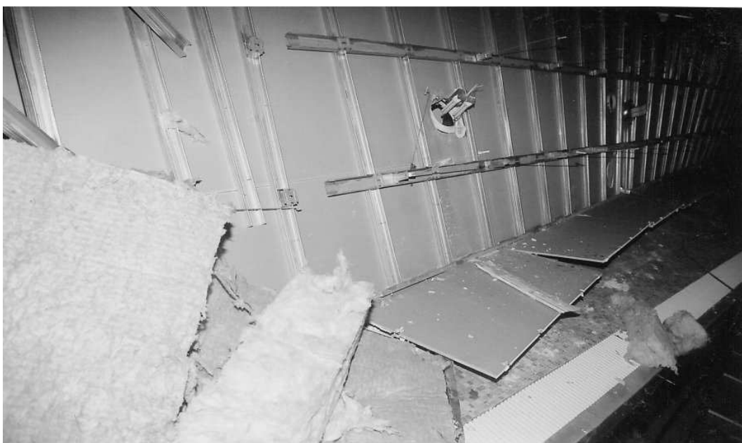
Rys. 4. Widok na konstrukcje zniszczonego stropu podwieszonoego, który zawisł przy ścianie wzdłuż jednej z krawędzi
