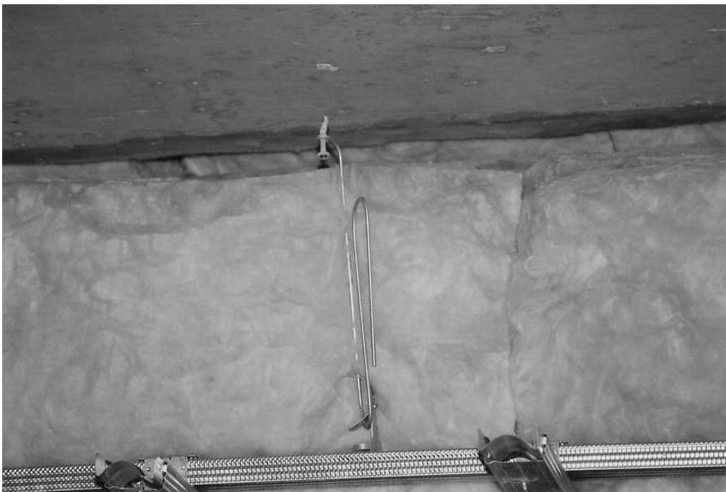
Rys. 3. Fragment przekroju poprzecznego stropu podwieszony z wełną mineralną. Widoczny „wieszak” z drutu ocynkowanego oraz kołek rozporowy „wyciągnięty” do połowy ze stropu żelbetowego nad basenem
