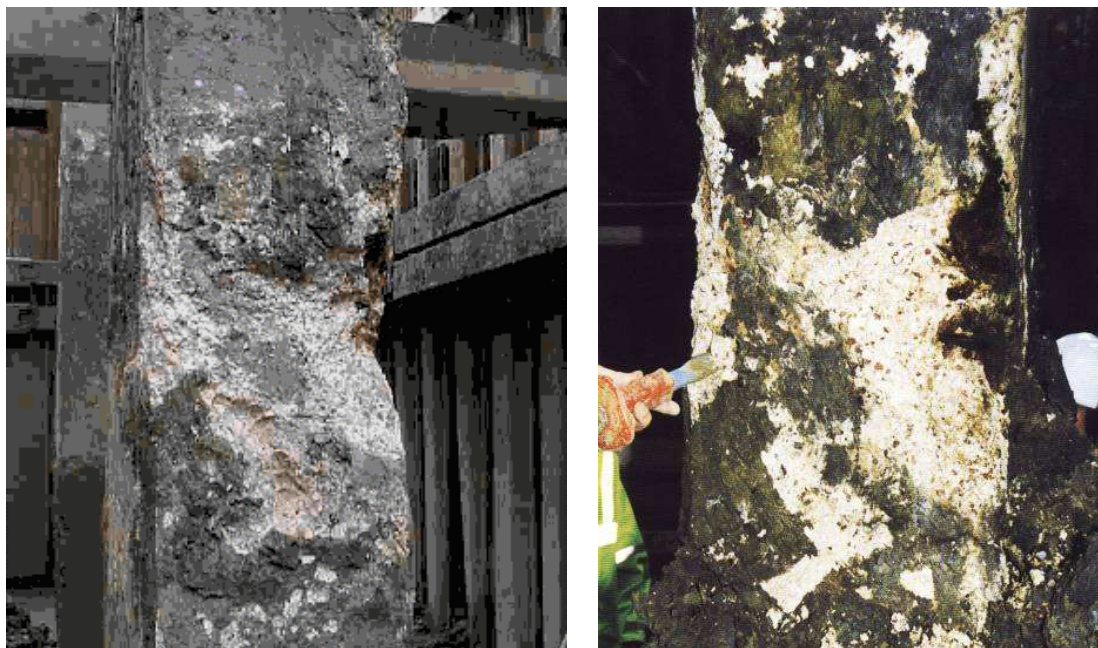
Rys. 4. Przykłady zniszczeń spowodowanych korozją thaumasytową: odsłonięte filary wiaduktu drogowego [4]
