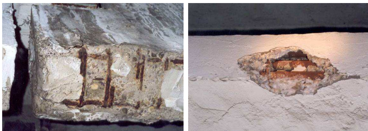
Rys. 5. Skorodowane elementy posadowienia trybun stadionu Puskasa w Budapeszcie [12]
