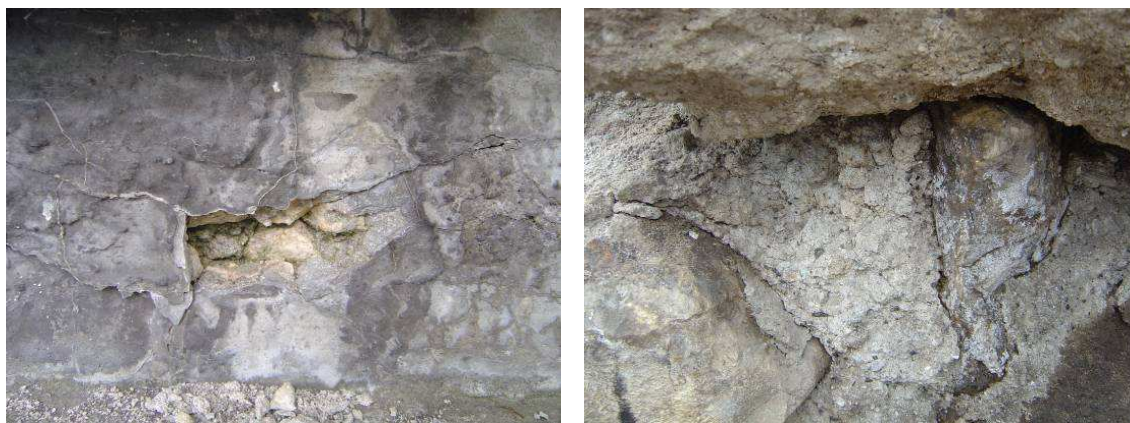
Rys. 6. Zniszczone fundamenty kamienicy w Starym Mieście w Wieliczce
